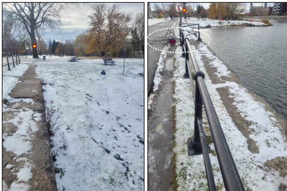
Photos 14 & 15 - Disparition du mur, égouts et clôture étrangement encrés, secteur du parc de l'Ancienne-Cour-de-Triage
