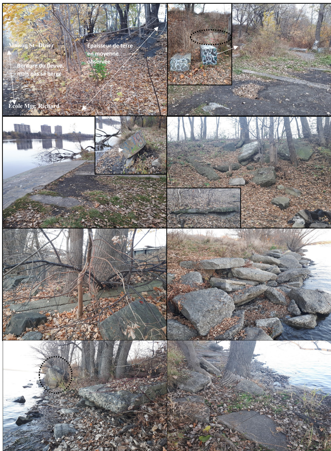
Montage photos 4 – Aperçu de l'épaisseur de terre, des différentes dalles et autres gros morceaux de bétons transportés et enfouis à intervalles réguliers tout le long de la berge... il y a de cela au moins cent ans
